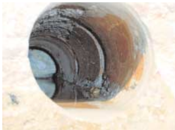
Fig. 4 - Particolare della mancanza di allettamento nello spessore interno
