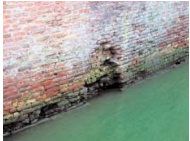
Fig. 1 - Esempio di degrado della tessitura muraria
