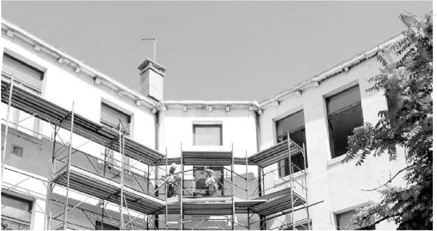
LAVORI IN CORSO Sono cominciati gli interventi di consolidamento statico all'elementare Manzoni, nel sestiere di Santa Croce
